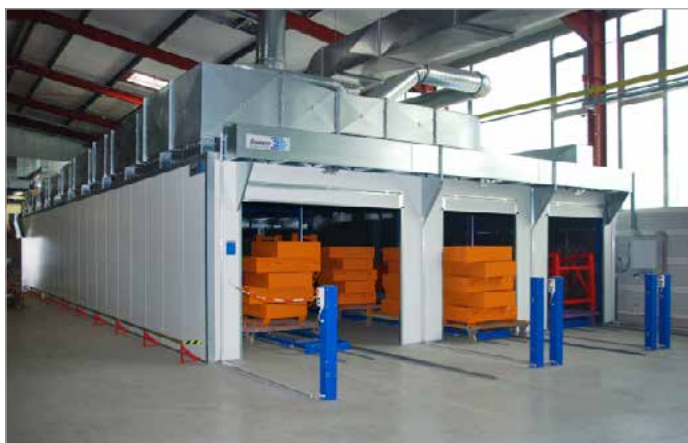
Halle de peinture avec tunnel de séchage
